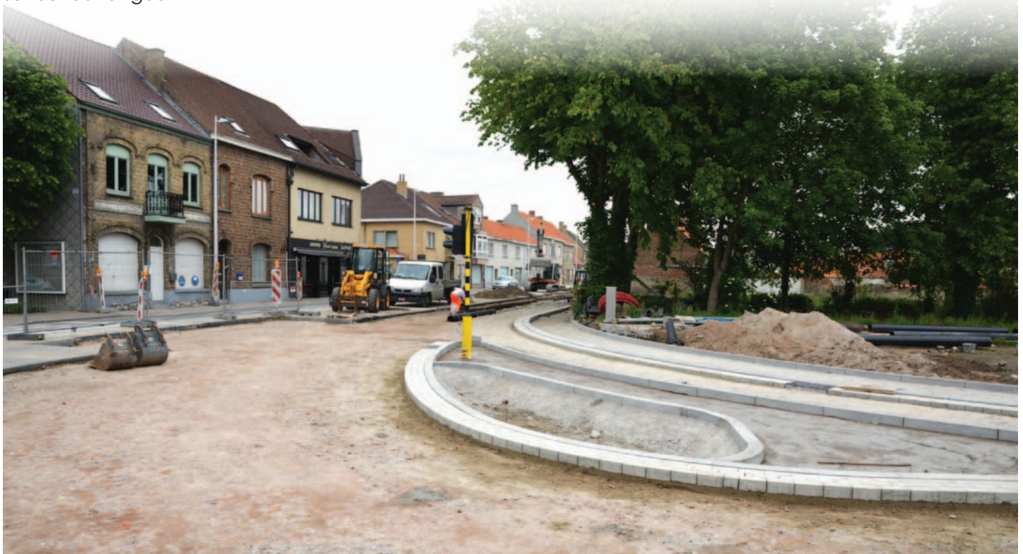
Op de hoek van de Dorpstraat-Toekomstlaan is bij het verschijnen van dit nummer de nieuwe afslag richting Nieuwpoort nagenoeg gerealiseerd (foto op 21 mei).
